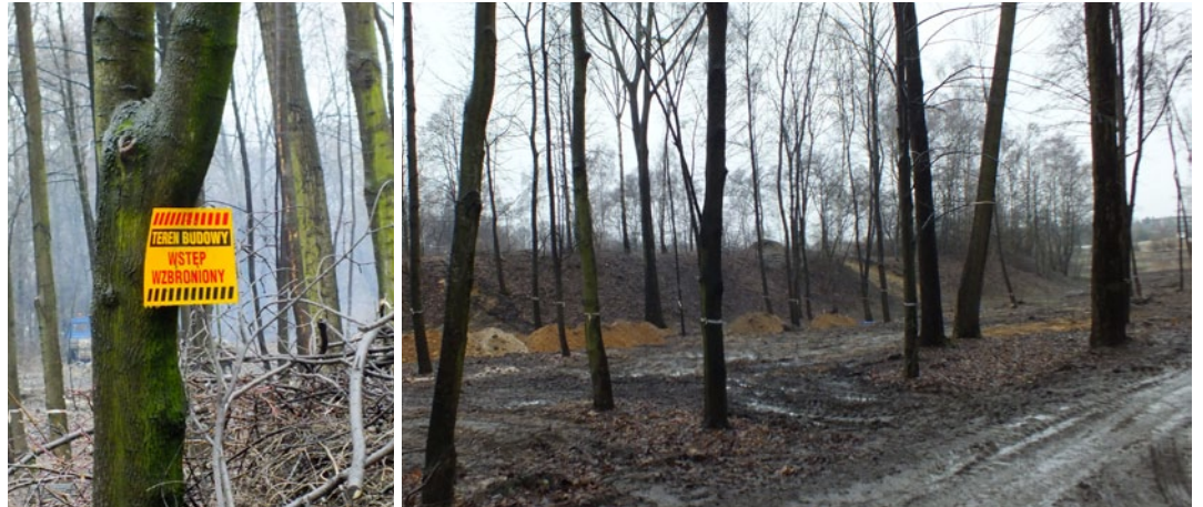
Trwają prace na placu budowy. Na zdjęciu obok: Drzewostan pozbawiony topoli od ulicy Zejera.
